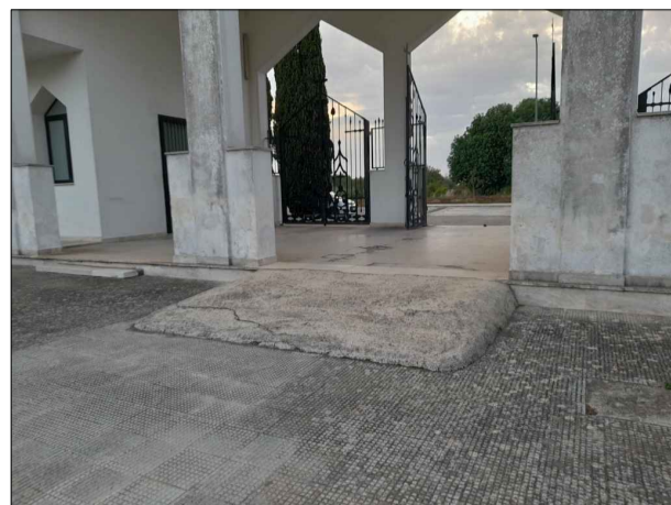
7. La rampa interna di ingresso al cimitero nuovo. Vista dall'interno. Il risalto tra il pavimento interno e la partenza della rampa risulta essere eccessivo per una sedia a ruote o passeggino.
