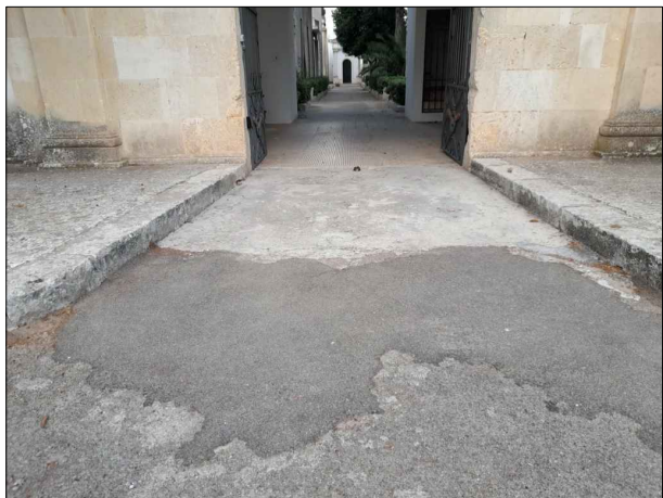
1. L'ingresso al cimitero vecchio. Si noti il fondo di calpestio disconnesso
