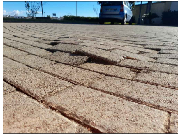
6. Particolare della disconnessione della pavimentazione. Al momento del sopralluogo è presente solo questa disconnessione. Una scarsa manutenzione renderebbe la pavimentazione non adeguata al passaggio di una sedia a ruote ovvero passeggino.
